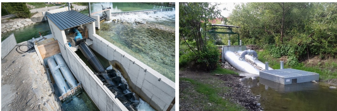
Abbildung 11 Zwei-Kammern-Fischwanderhilfe: Links: parallel zur Restwasserschnecke, KW Lippenannerl; rechts: Aschacharm, KW Leumühle
